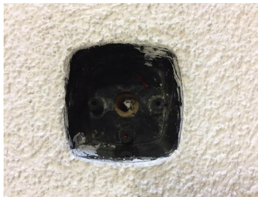
Foto 7 - Indbygningsdåse og overgang til væg - efter test
